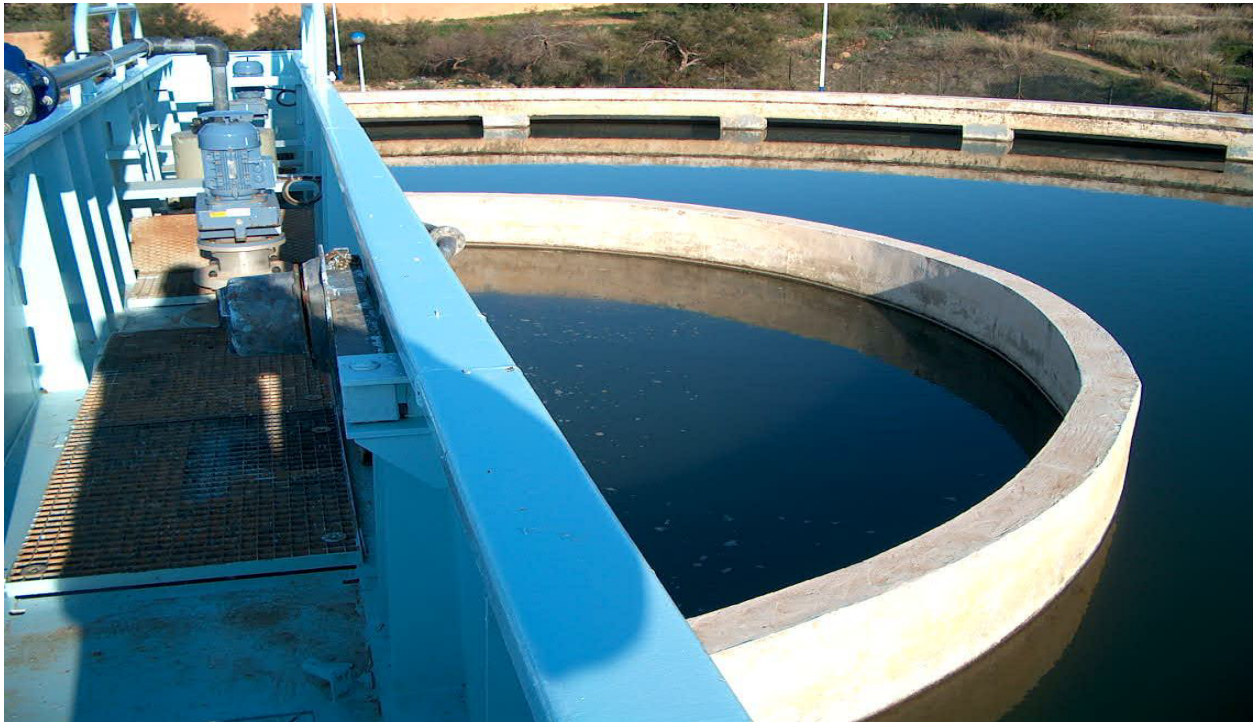
Photo 02 : Coagulateur, flocculateur et décanteur.
