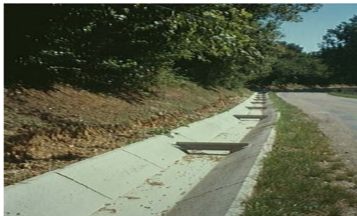
Figure VII.N°08 : fossé en béton armé.
