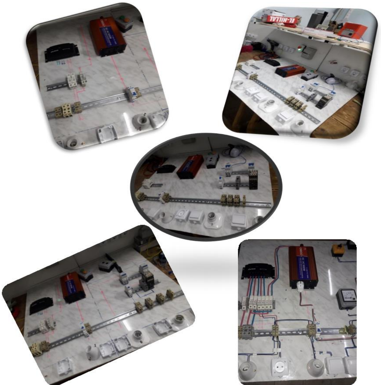
☞Figure III .3. Différents étapes pour la réalisation de l'armoire solaire.
