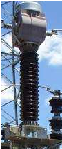
Fig II.13. Transformateur de tension
