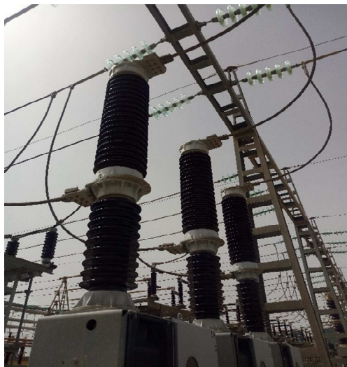
Fig II.14. Transformateur de courant
