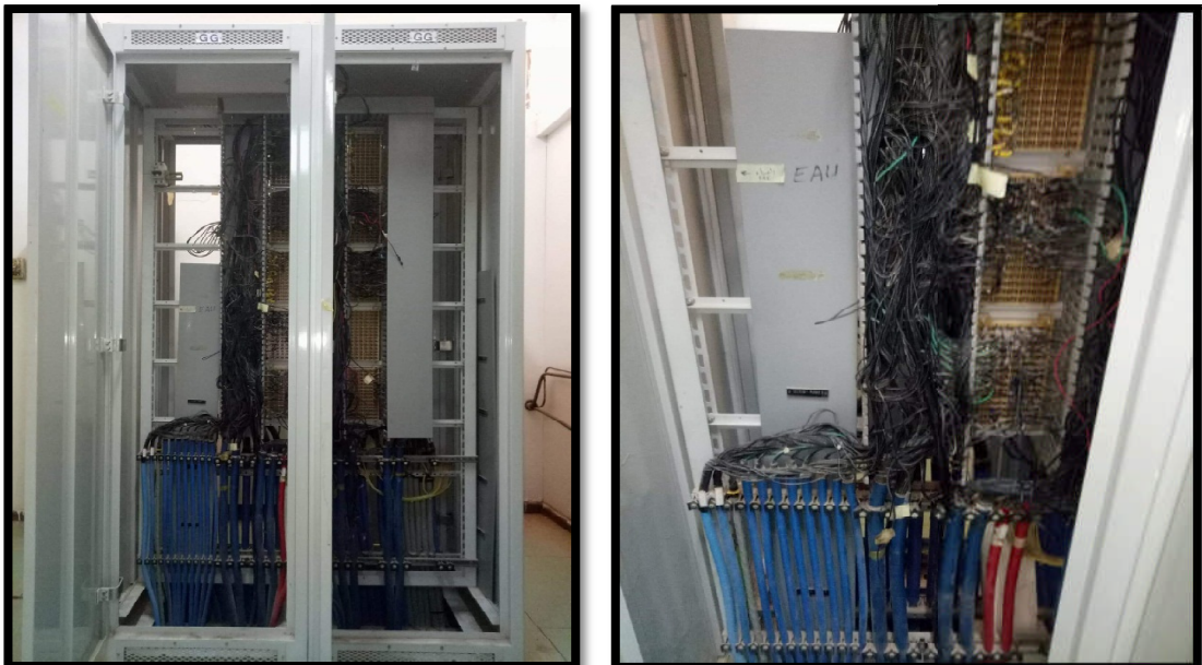
FigureIII-6 Armoire répartiteur station GG avec (02) sections et (10) plaques
