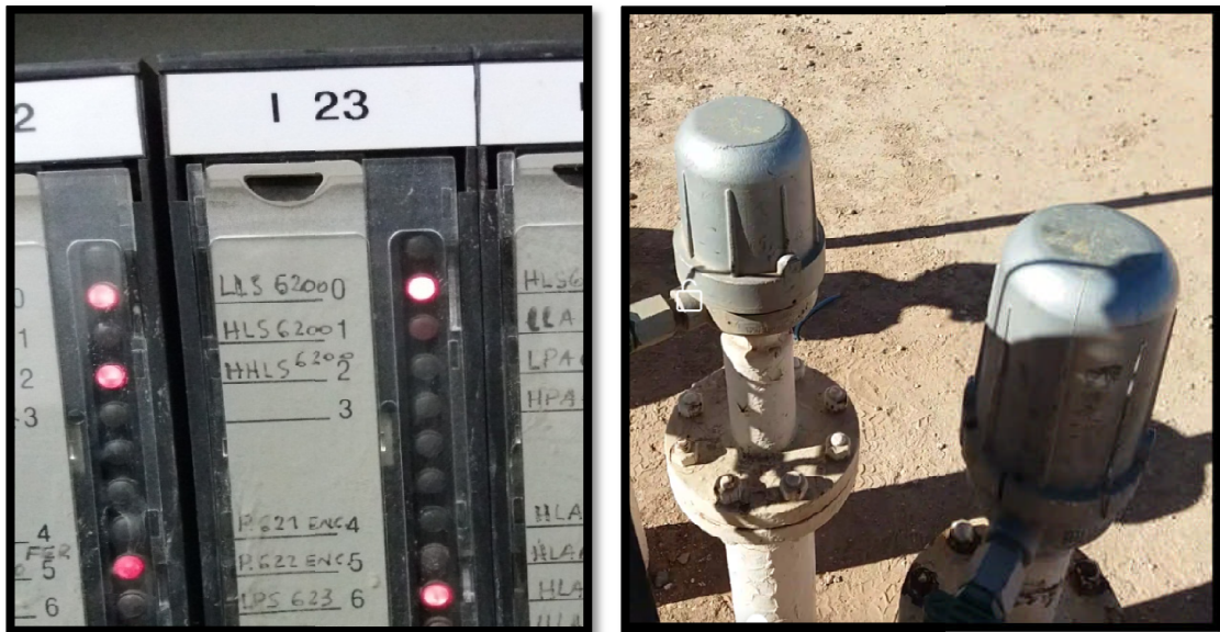
Figure III-13 Les SwitchLS6200 des deux flotteurs à mercoides
