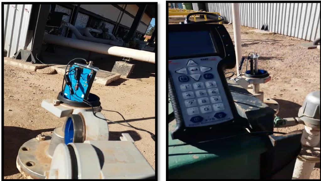
Figure III-10 Etalonnage transmetteur 'Magnétrol' avec le 'PocketHART375'
