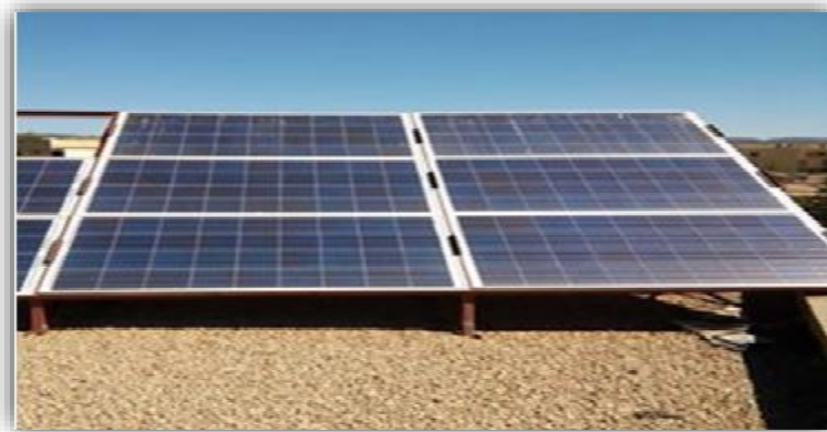
Figure.3.3 : Panneaux solaire utilisés dans le projet.
