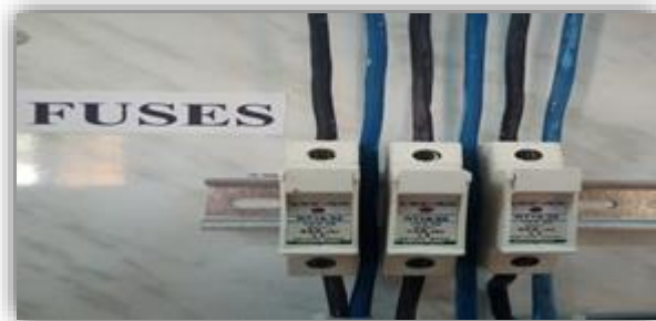
Figure.3.7 : Fusible de protection.
