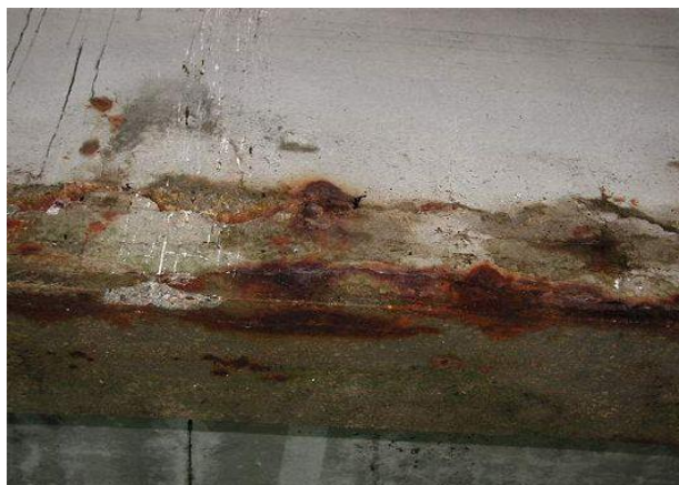
Figure I. 3: Poutre corrodé au bord de la mer
