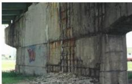
Figure I. 2: Structure atteinte par l'attaque des chlorures
