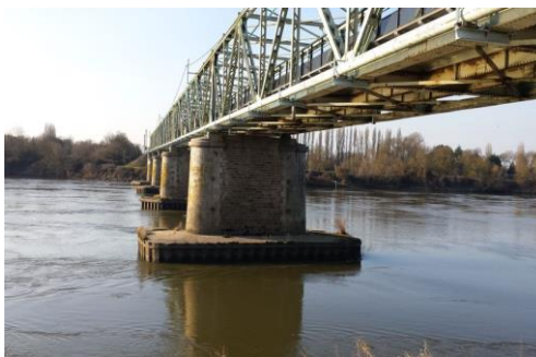
Figure I. 1: Corrosion d'un pont métallique
