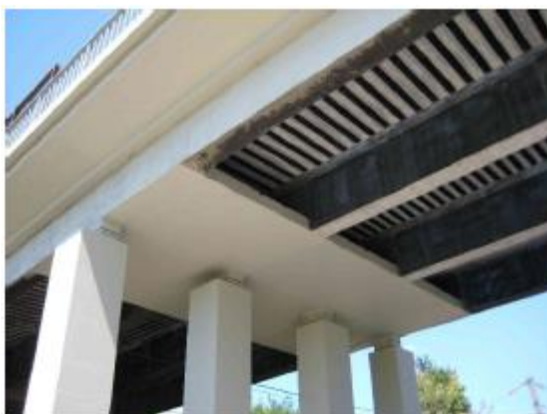
Figure I. 6: Tablier de pont renforcé par matériaux composites
