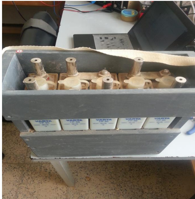
Figure III- 22 : La batterie Nickel avec la possibilité de mesuré la tension de chaque chambre
