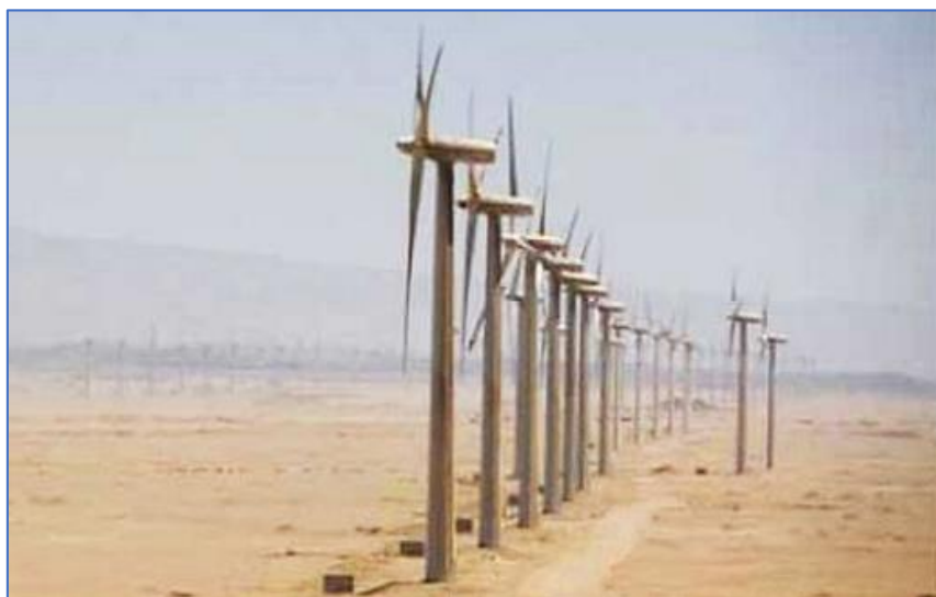
Fig. I-11 : Éolienne de 100 KW de Grand Vent.
