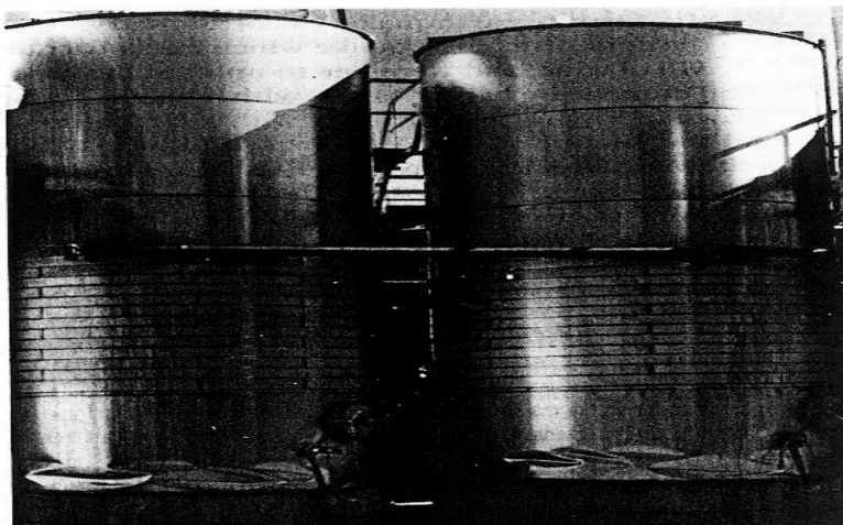
Figure II.9: Réservoir flambé après séisme (mode en pointe de diamant)
