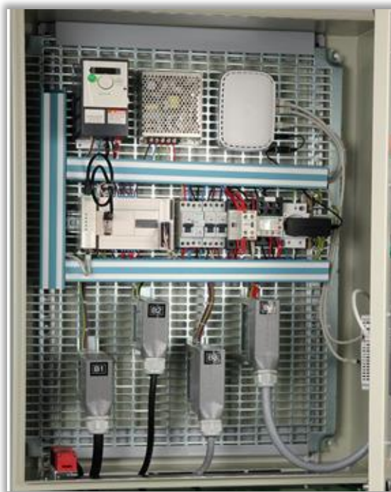
Figure II.5 L'équipement de l'armoire électrique.
