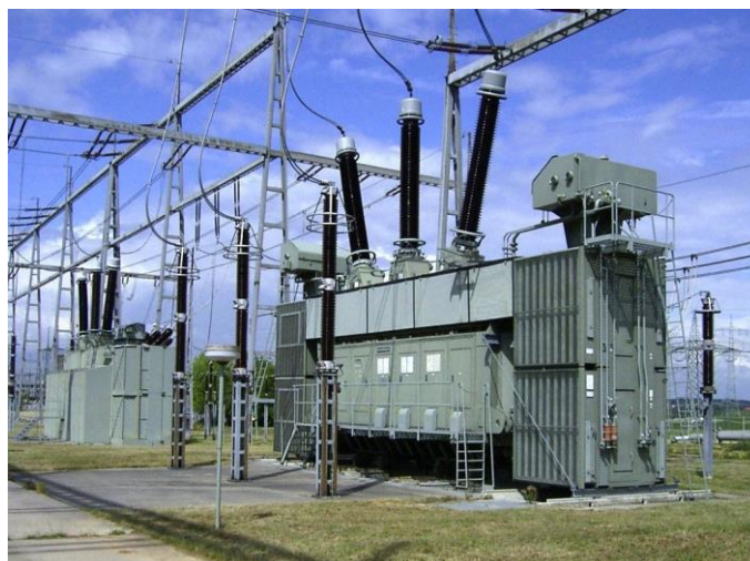
Figure I.7 : Transformateur de puissance de 120 MVA [17]
