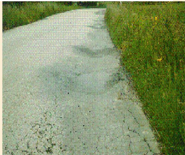
Figure III.4 : exemple de désordre sur une chaussée non drainée (photo : SETRA).
