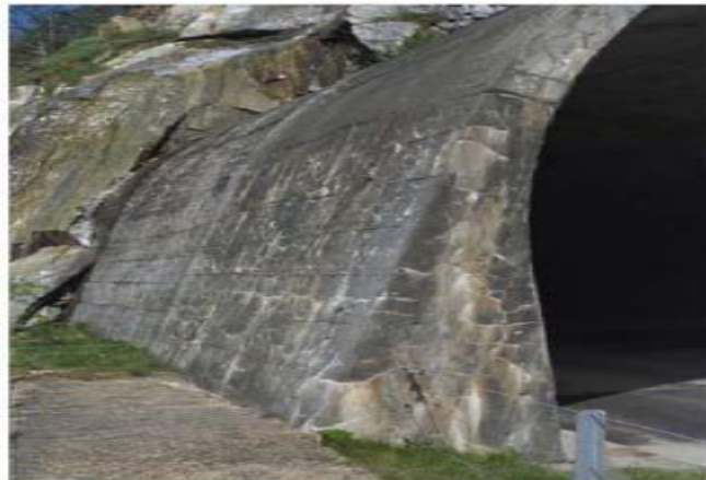
Figure I.3 : Entrée d'un tunnel, Fissurations grossières dues à l'alcali-réaction [Rabahi 2013]
