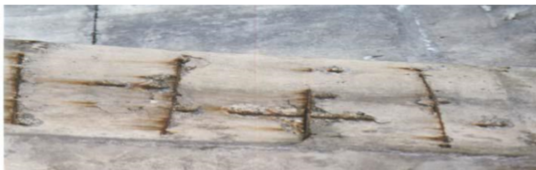
(b) Corrosion des armatures.
