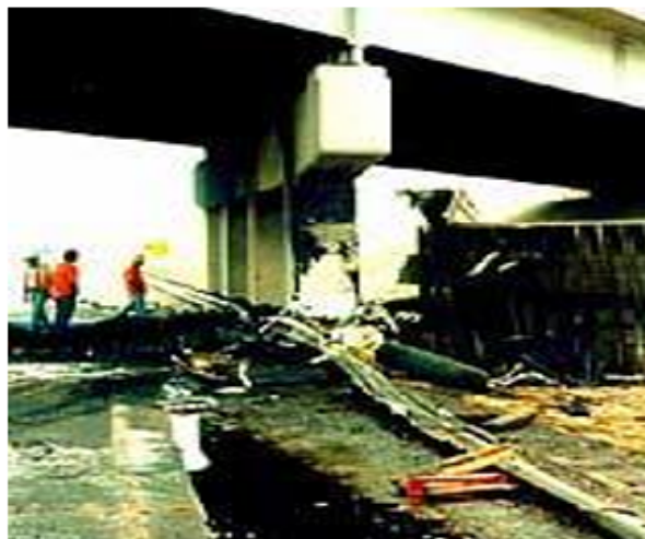
Figure I.4 : Choc sur une pile de pont [Rabahi 2013].
