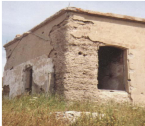
Figure I.1 : Dégradation d'un ouvrage soumis au gel dégel [Rabahi 2013]
