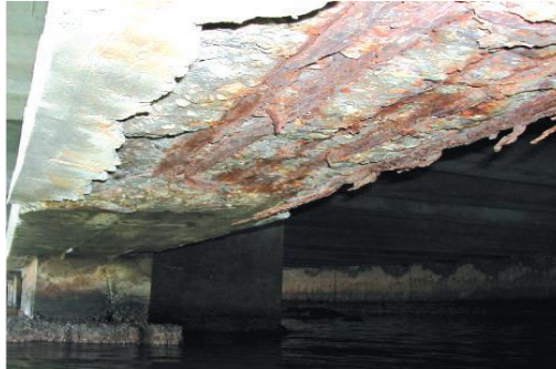
Figure I. 11: Corrosion importante en sous-face d'une poutre de pont.
