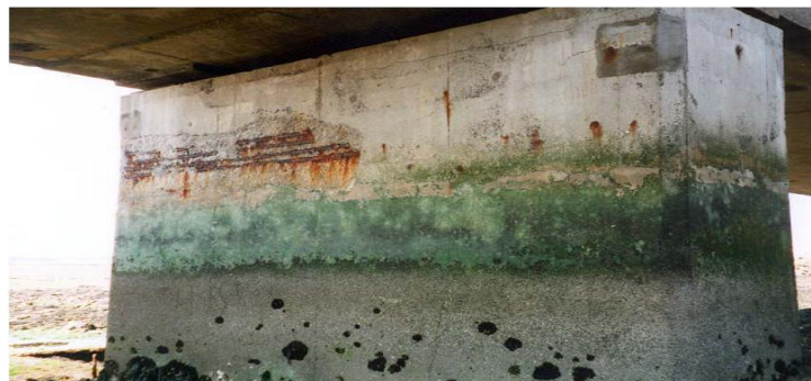
Figure I. 4 : Dégradations dues à l'eau de mer (Ait Amar, cour pathologie. 2019-2020)
