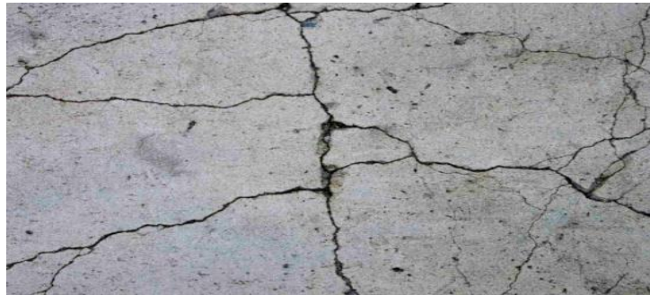
Figure I. 13: Fissure superficielles dans le mur et mesurée son ouverture.
