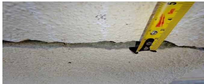
Figure I. 12: Fissure structurelle dans le mur et mesure de son ouverture.
