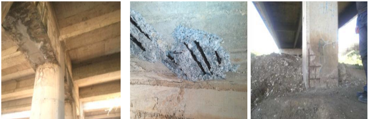
Figure I. 9 : Exemples de la corrosion dans des ouvrages d'art (Ponts) en Algérie
