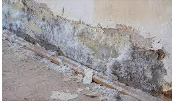
Figure I. 14 : Cette image illustre l'effet de l'humidité sur la structure de mur.
