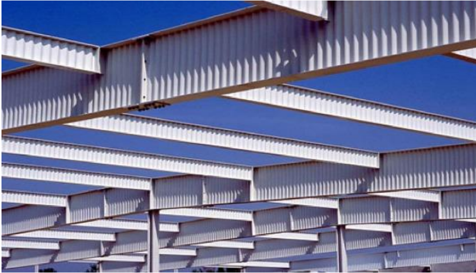
Figure II.1 : Poutre à plaque avec âme ondulée et différentes hauteurs d'âme sans raidisseurs.
