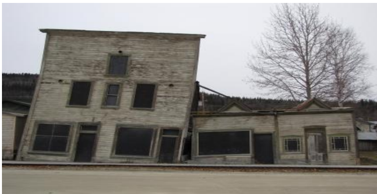
Figure I.5 : Tassement différentiel. (BADOUR, 2018).
