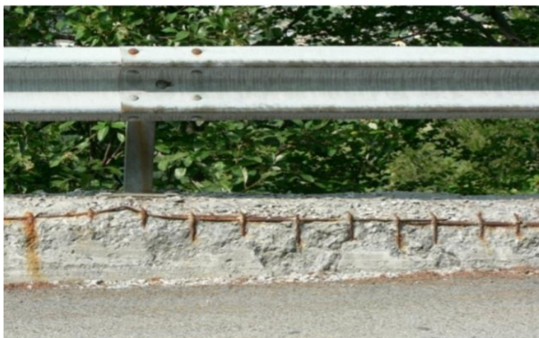
Figure I.3 : Effet du gel-dégel sur le béton : écaillage du béton d'enrobage et corrosion des armatures. (BOUACHRIA and KARI, 2021).
