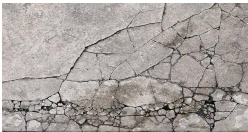
Figure I.4 : Fissuration du béton. (BOUACHRIA and KARI, 2021).
