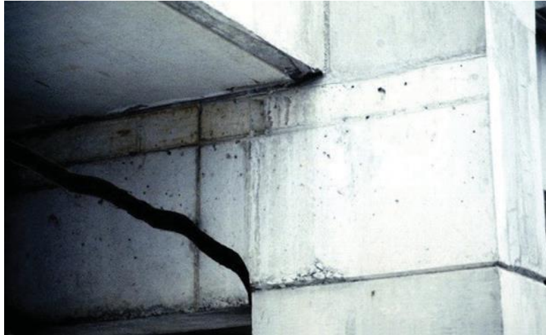
Figure III.5 : Rupture en cisaillement de la poutre. (NGO Minh Duc, 2016)
