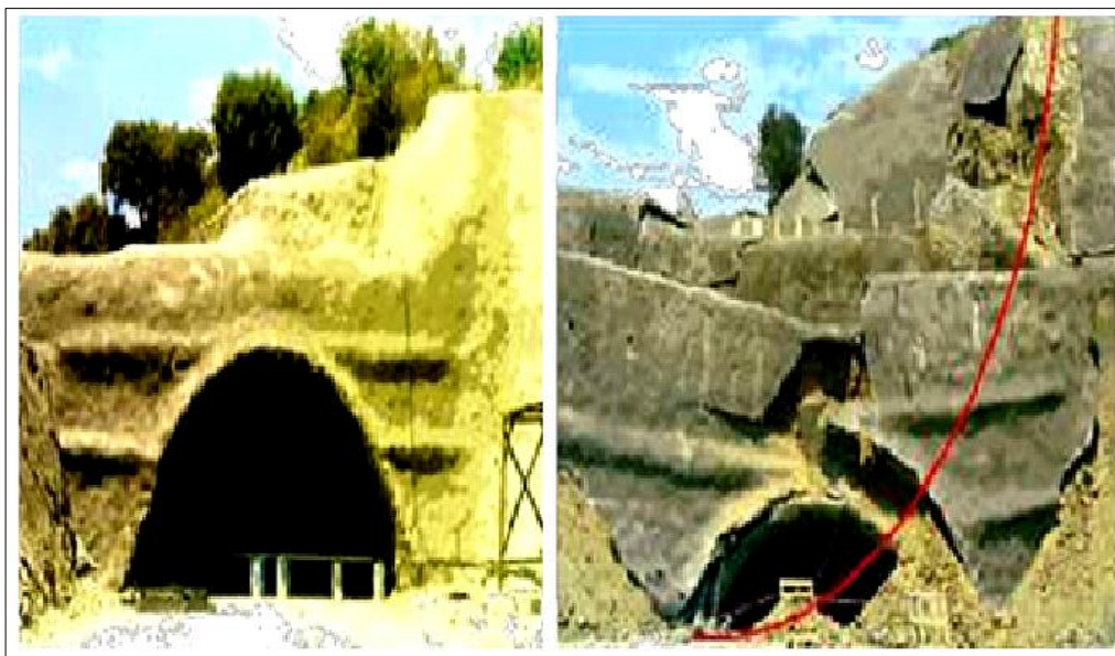
Figure I.17: Tunnel de Patra avant et après l'effondrement (Grèce, août 1998) (BERKANE, 2020).
