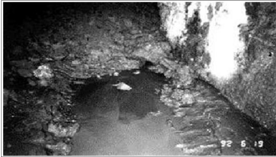
Figure I.18: Inondation du tunnel de Wushantou, Japon 1992 (BERKANE, 2020).
