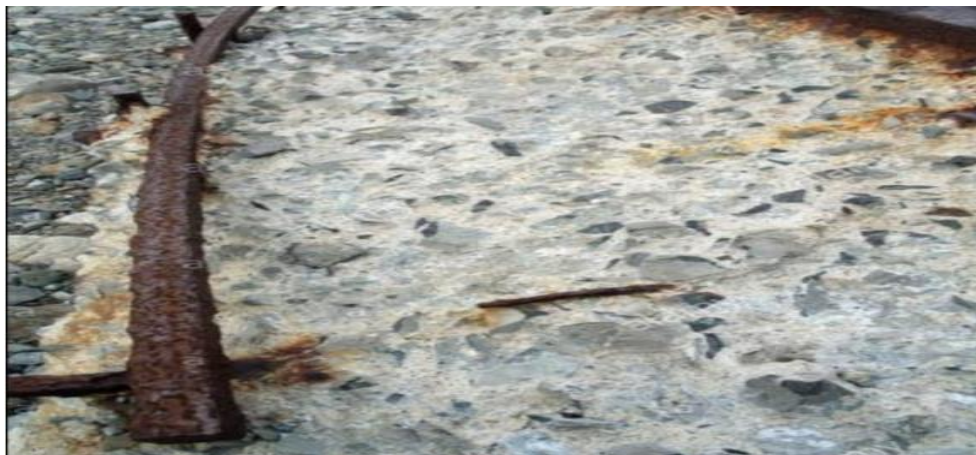
Figure.I.2: l'érosion du béton(BOUACHRIA and KARI, 2021)
