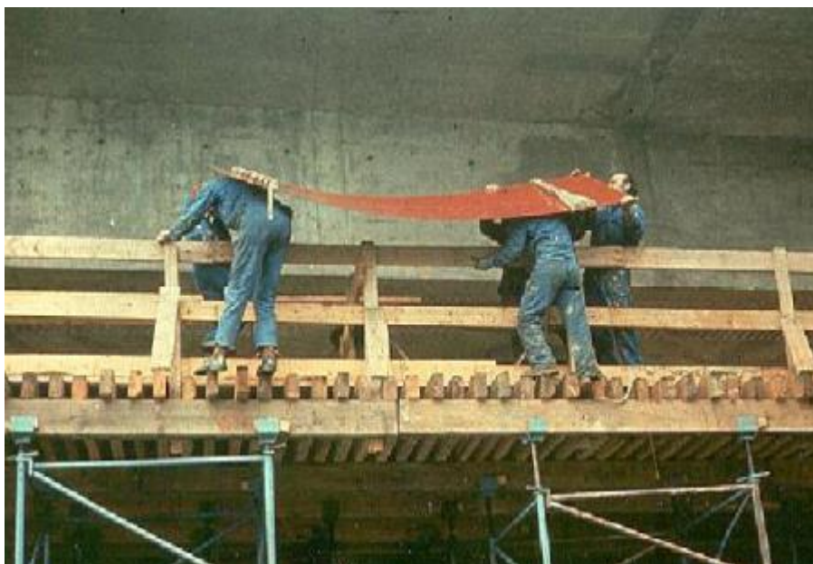
Figure I.14: renforcement par collage de plats métalliques (BADOUR, 2018)
