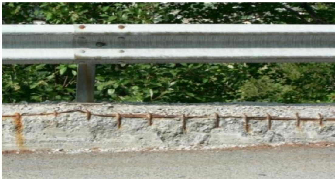
Figure.I.6: Effet du gel-dégel sur le béton : écaillage du béton d'enrobage et corrosion des armatures. (BOUACHRIA and KARI , 2021)
