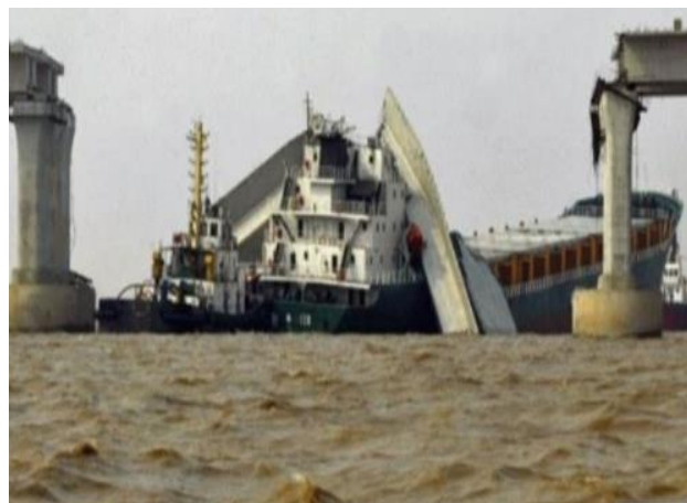
Figure.I.4: Grave conséquence de collision contre la pile d'un pont (d'un bateau).(BOUACHRIA and KARI , 2021)
