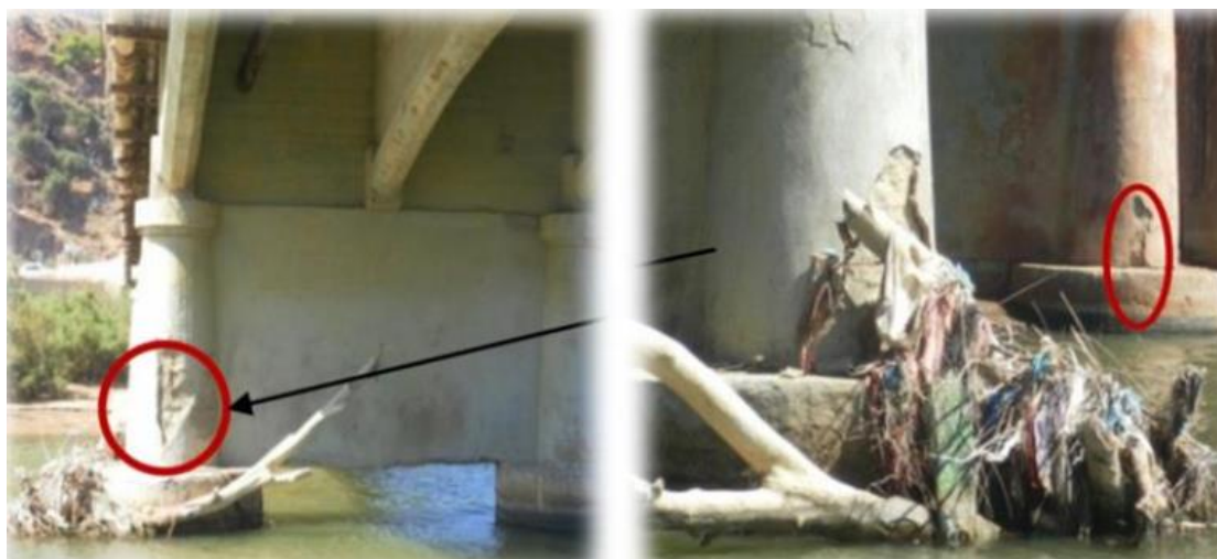
Figure.I.3: Désordre à la base des piles du pont sur Oued Allala (Ténès-Algérie) sous l'effet de l'abrasion.(BOUACHRIA and KARI, 2021)
