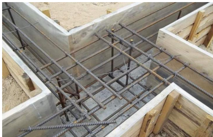
Figure I.6. Erreur de ferrailage
