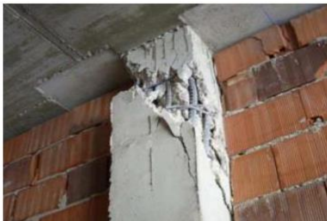
Figure I.7. Endommagement du poteau causé par le déplacement du coffrage
