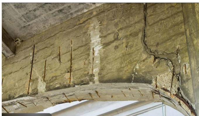
Figure I.8. Effet de la dégradation
