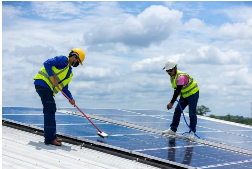
Figure I-9: Nettoyage des panneaux avec de l'eau et un balai
