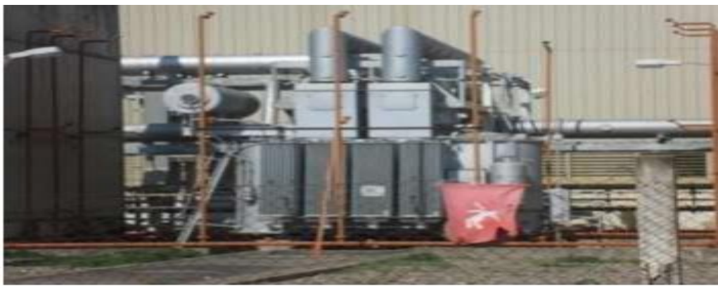
Figure III-4 Transformateur de soutirage
