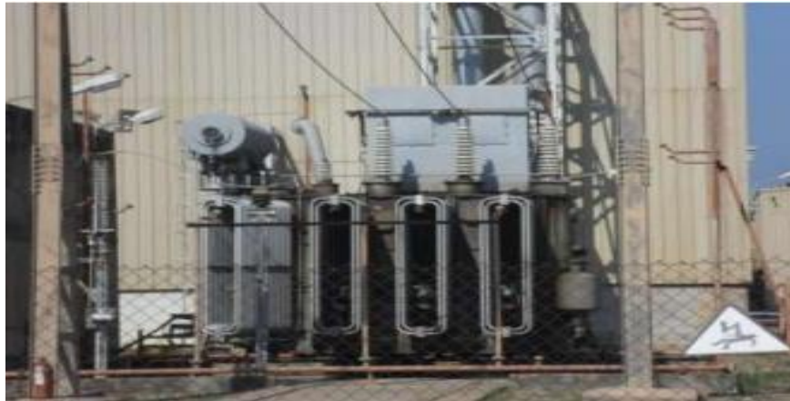
Figure III-5 Transformateur de soutirage
