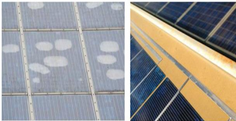
Figure I-16 : Dégradation du module photovoltaïque par délamination
