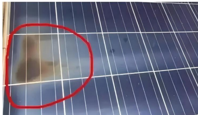
Figure I-19 : Dégradation du module photovoltaïque par des points chauds sur les bords des coins supérieurs [13]
