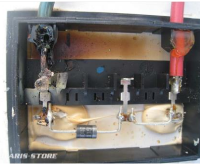
Figure I-22 : Exemples de défauts rencontrés dans les boîtes de jonction
