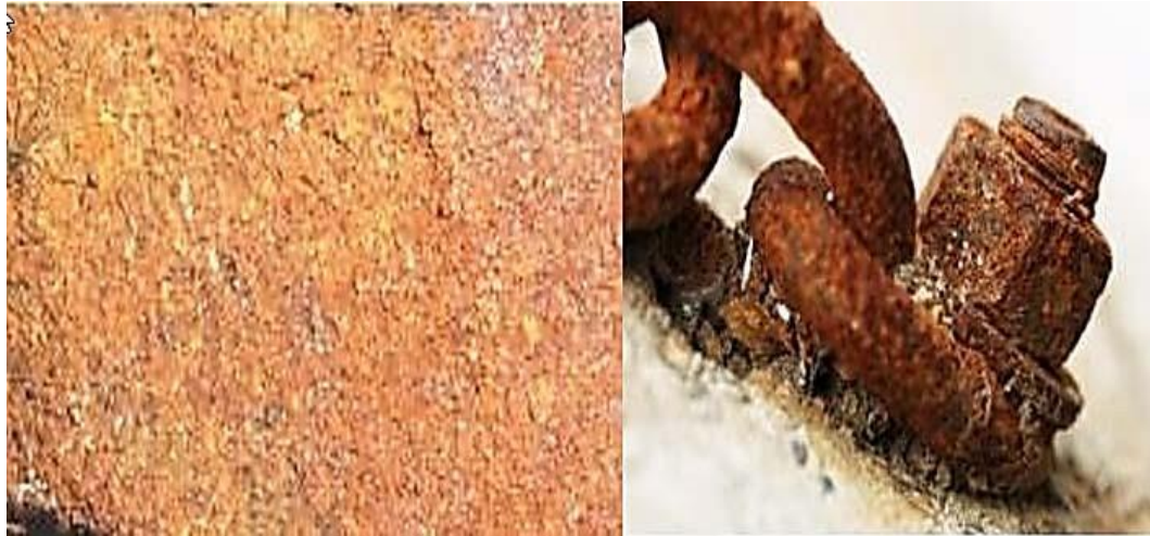
Figure I.2 : Exemples de corrosion uniforme [8].
