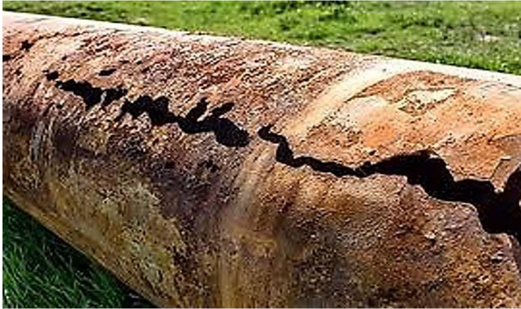
Figure I-9 : Corrosion-érosion d'un tuyau [8].
