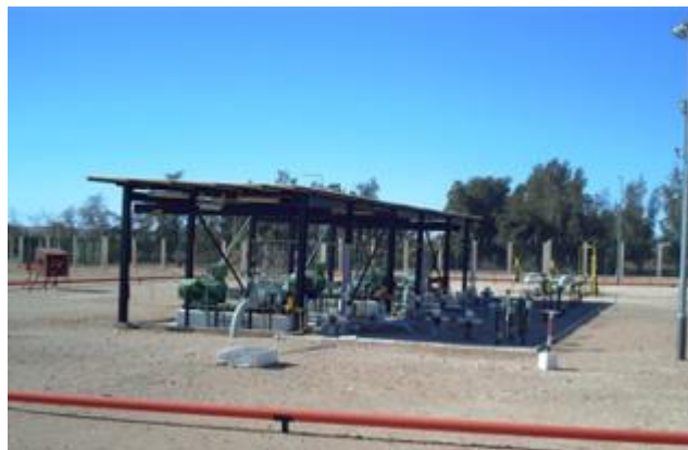
Figure 2.7 STATION LNZ1 '12', mis en service 1973, capacité de transport 0.85 MTA de GPL [10].
