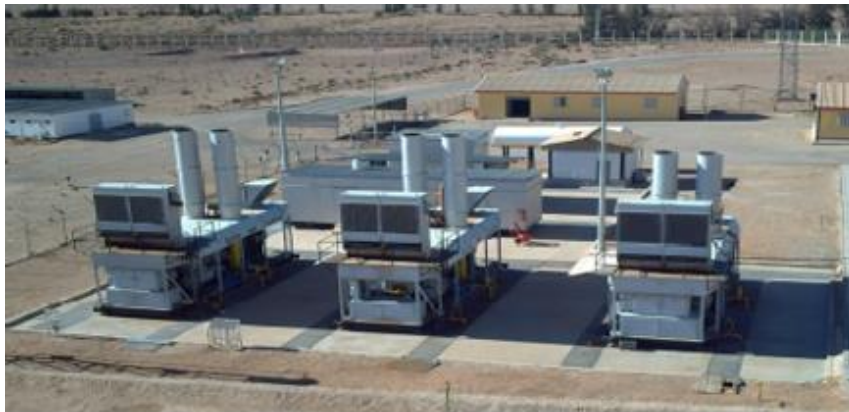
Figure 2.8 Centrale électrique, composée de trois turboalternateurs d'une puissance totale de 3.6 MW [10].
