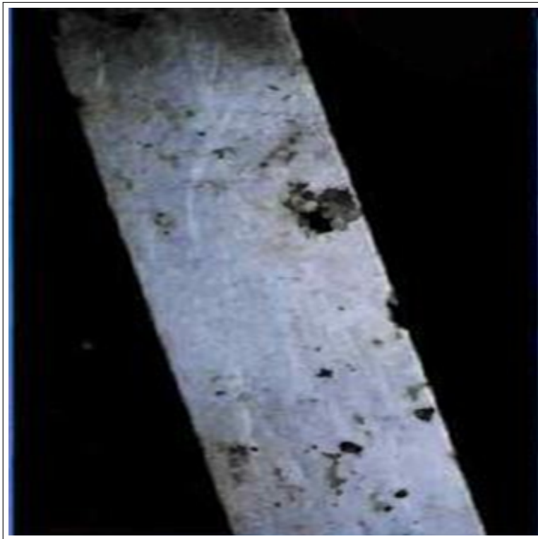
FIGURE 2.28 Corrosion des renforcements métalliques .
