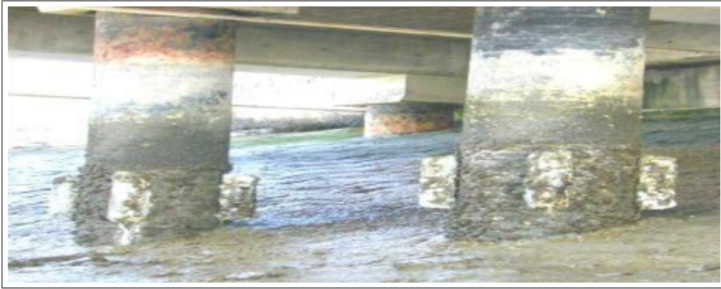
FIGURE 1.10 Pathologie des pieux due à l'attaque sulfatique .
