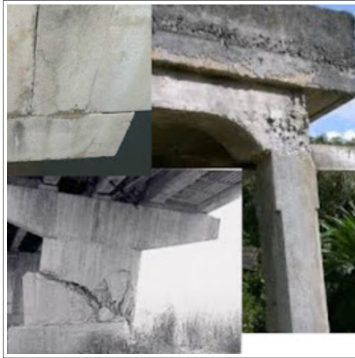
FIGURE 1.11 Fissure sur les différents types d'ouvrages .
