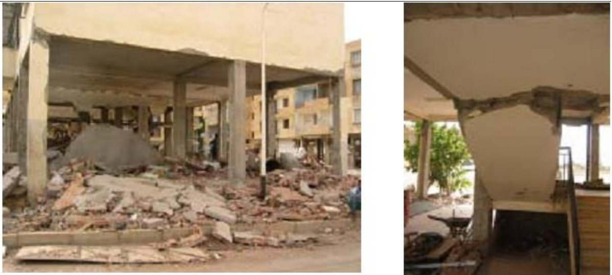
Figure V-2 - Chute d'éléments non structuraux : séisme de Boumerdes (21 mai 2003)
