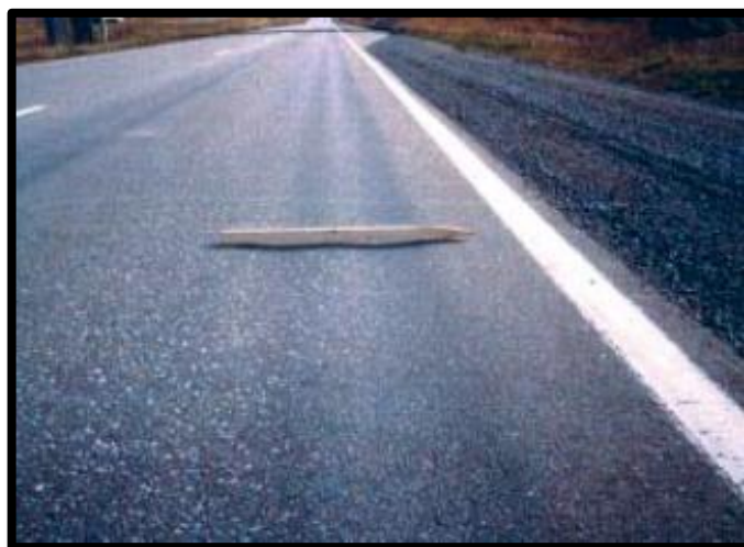
Faible : profondeur de l'ornière < 10 mm
