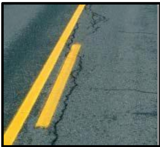
(a) : Fissures dans la bande de roulement
