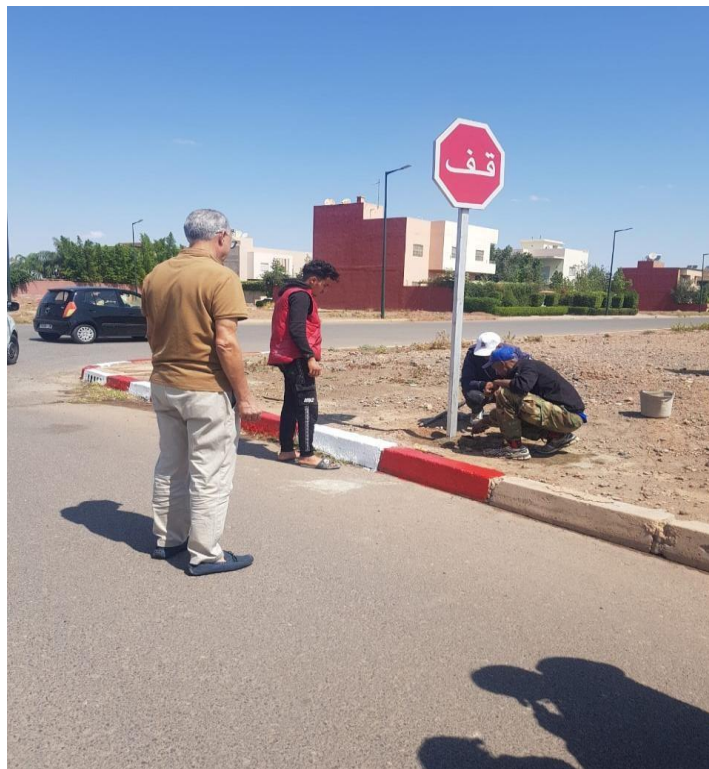
Figure IV.13 : Comment réparer les panneaux routiers
