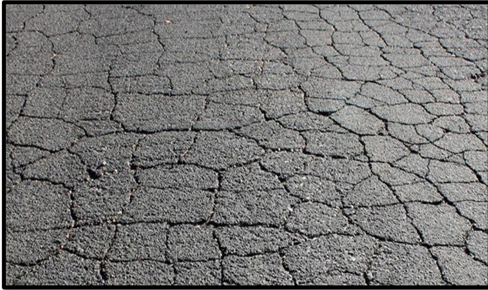
Figure II.3 : Fissures longitudinales de type faïençage
