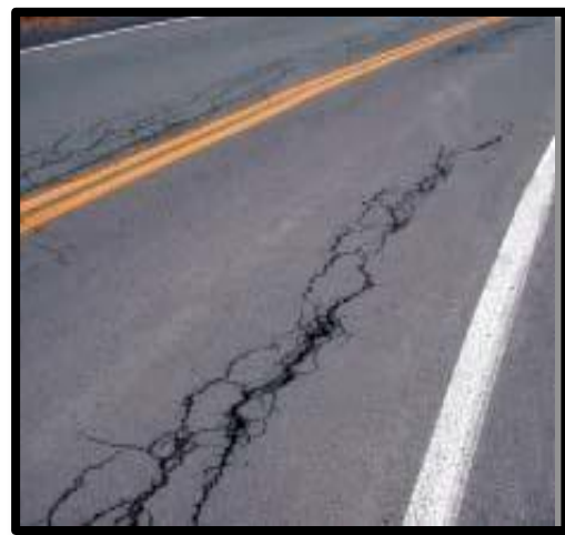
(b) : Fissures hors bande de roulement
