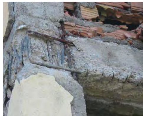
Figure I. 13 : Absence d'armatures transversales dans le nœud.
