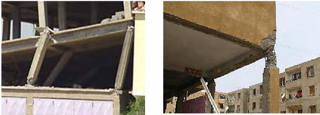
Figure II. 8 : Formation des rotules plastiques en tête et pied des poteaux [3]
