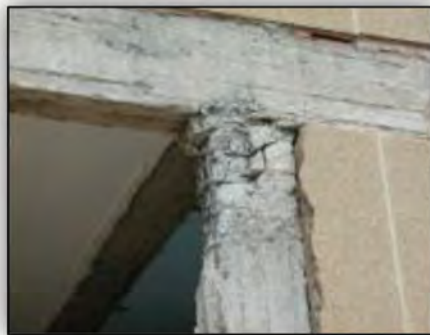
a) Comportement sismique défavorable
