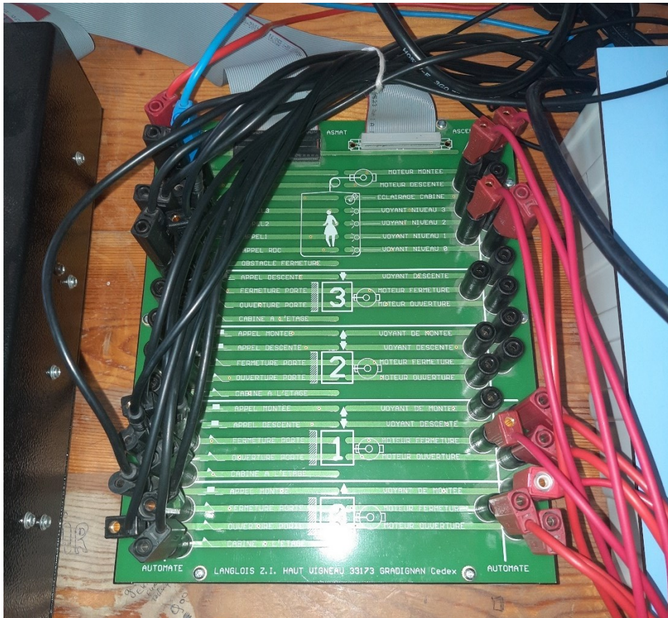
Figure 5. 23 : Interface de Connexion pour le Contrôle de l'Ascenseur ASC89.
