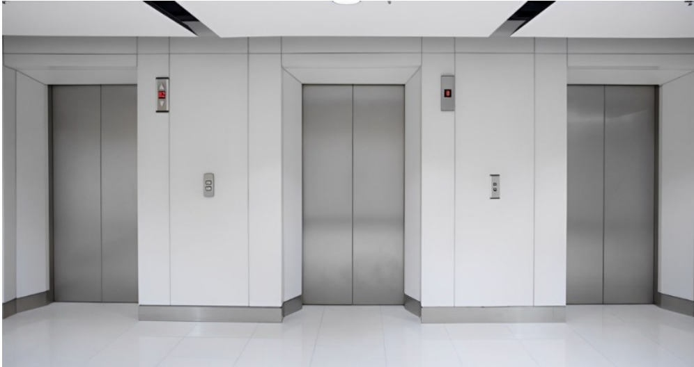
Figure 5. 1 : Ascenseur à 3 cages et N niveaux (rez de chaussée et N-1 étages).
