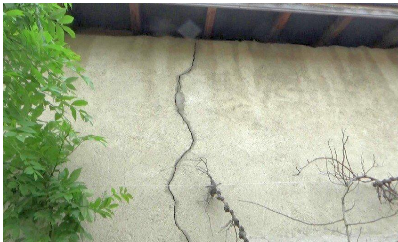
Figure 2.1. identifier les désordres de façade.
