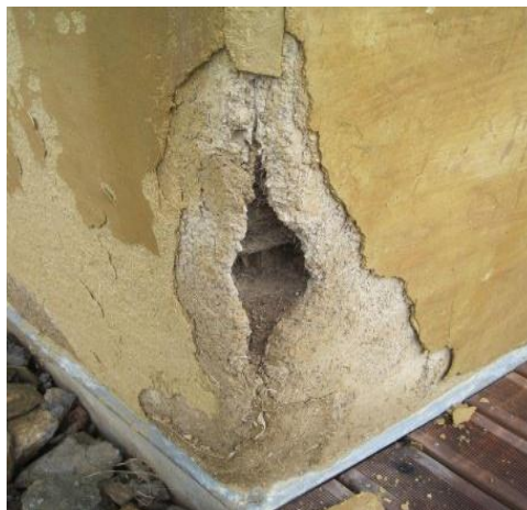
Figure2.3. La détérioration de l'enduit à la chaux sur un rempissage en terre paille s'est produite lorsque l'enduit est trop épais et mal dosé sur un angle exposé aux intempéries.
