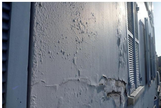
Figure2.5. Décollement de l'enduit monocouche.
