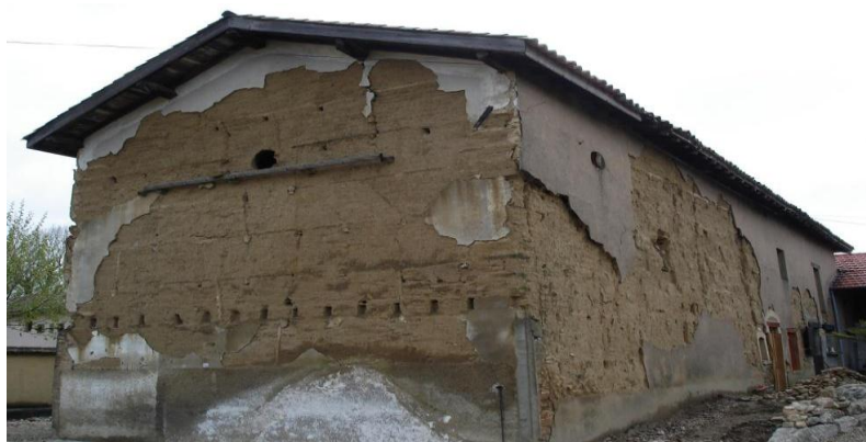
Figure2.8. Dégradation du mur en terre sous l'enduit.
