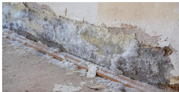
Figure2.6. Moisissures et humidité.
