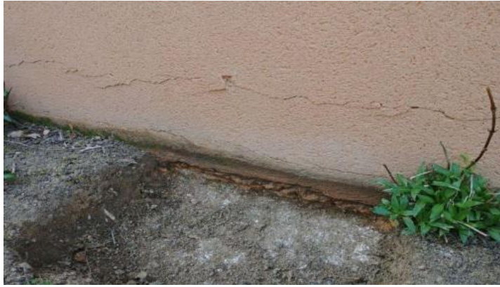
Figure2.4. Erosion de l'enduit, absence de protection en pied de mur.
