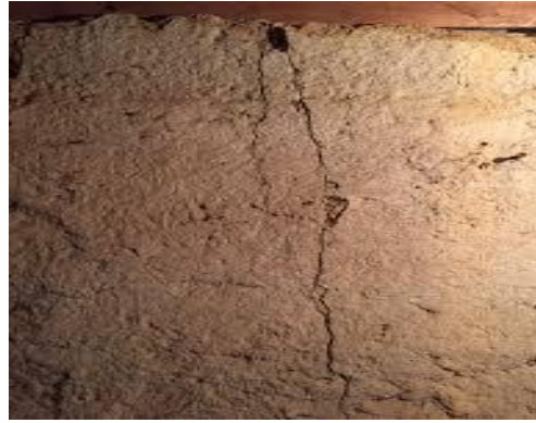
Figure 2.7. fissure mur en pisé.
