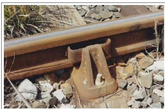
Figure 7.2. Rail double champignon on voie.
