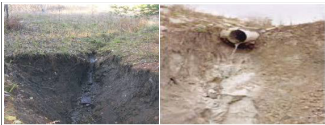
Figure 1.21: Exemples d'interventions qui ont pour effet de provoquer une concentration d'eau pouvant nuire à la stabilité d'un talus.
