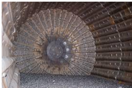
Figure I.4 : Vue intérieur du broyeur à boulets
