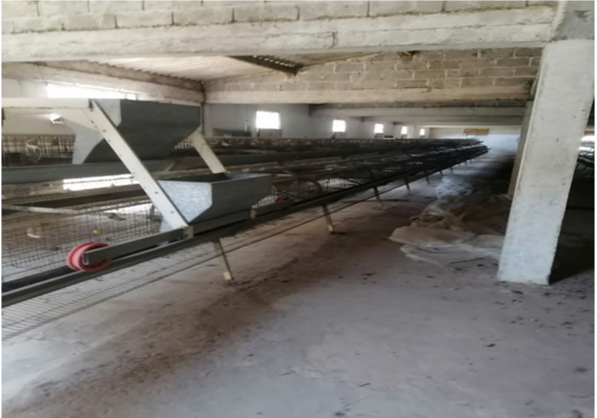
Photo 03 : chaine d'alimentation utilisé dans les bâtiments.
