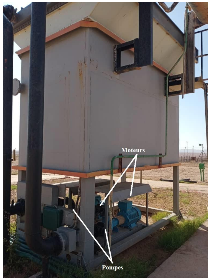
Figure II.6 : Vue d'ensemble du système Aero réfrigérant
