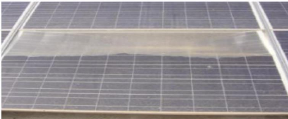
Figure II.2 : défaut de délaminage
