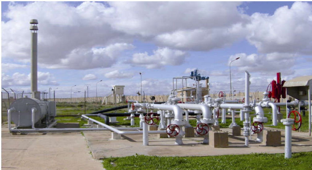
Figure 2.13 : Réchauffeur raccordé avec poste détente [25].
