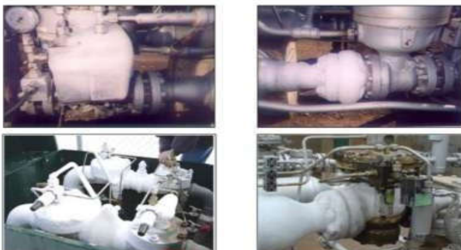
Figure 1.9 : Givrage du pilote du poste et de la partie aval de régulateur [16]
