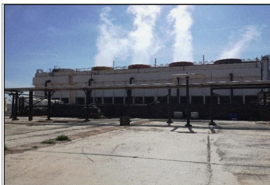
Fig. II.11 : Tour de refroidissement 33E101.[RA1Z]
