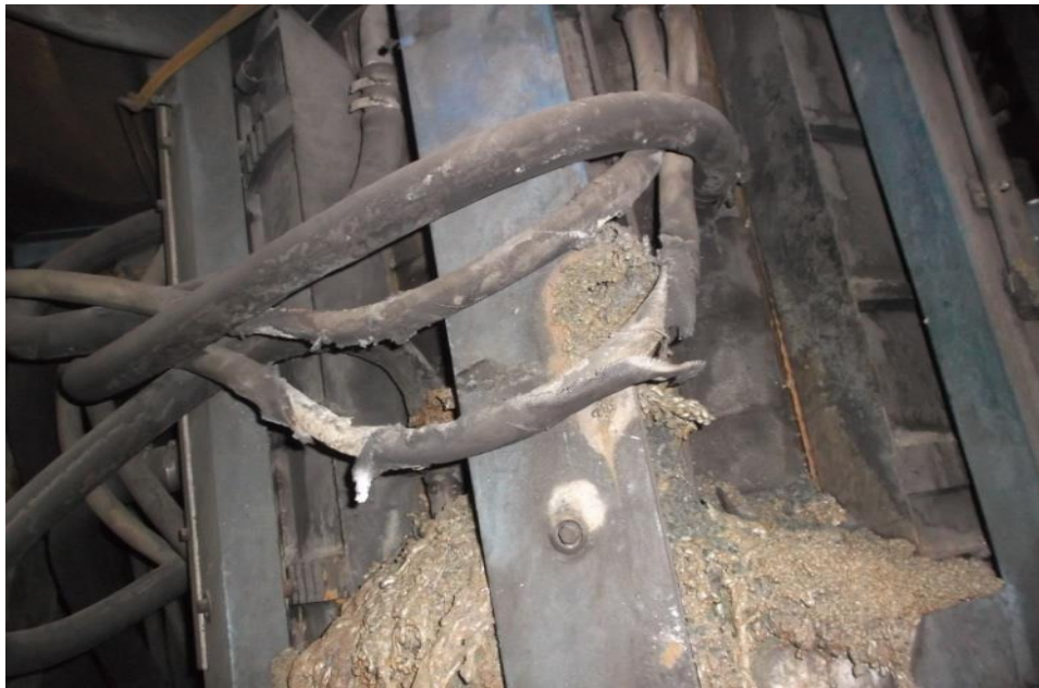
Figure 3.15 : câbles électriques endommagés.[prenez de ALFET]
