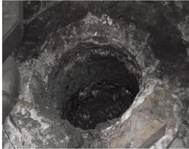
Figure 3.12 : Usure et rupture des matériaux réfractaires. [Prenez d'ALFET]
