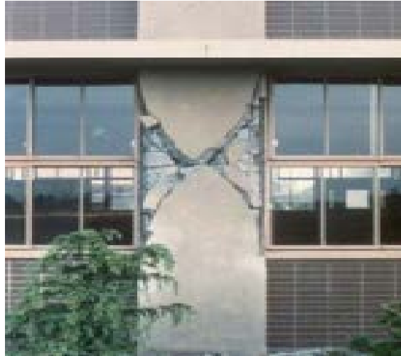
Figure II.14 : Séisme de Tokachi Oki, 1968
