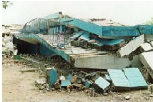
Figure II.4 : Destruction de tous les étages
