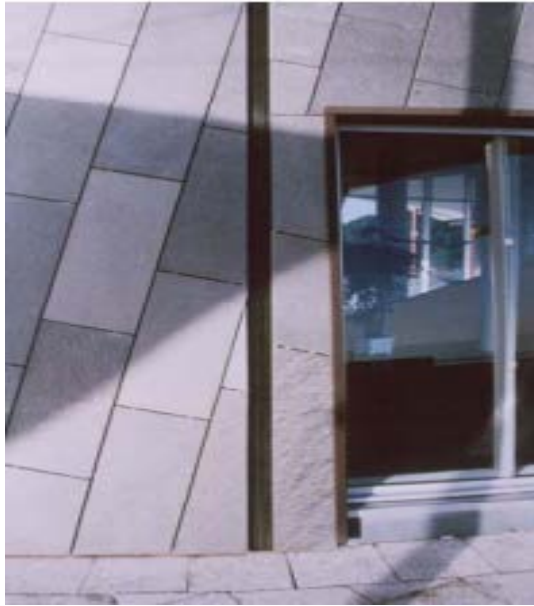
Figure II.16 : (Basse-terre, Document P. Balandier) - Joint parasismique vertical étroit entre deux parties d'un même bâtiment. Le joint PS est couvert d'un couvre joint souple
