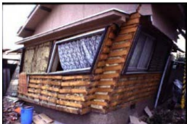
Figure II.20 : Les déformations acquises après séisme (Kobé, 1995, document NISEE)
