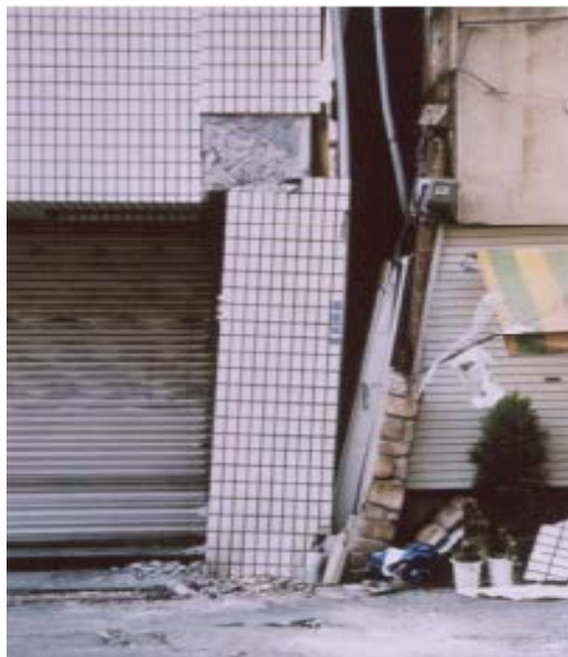
Figure II.17 : (Document X) Entrechoquement de bâtiments pour cause de joint PS trop étroit au regard des déplacements réels
