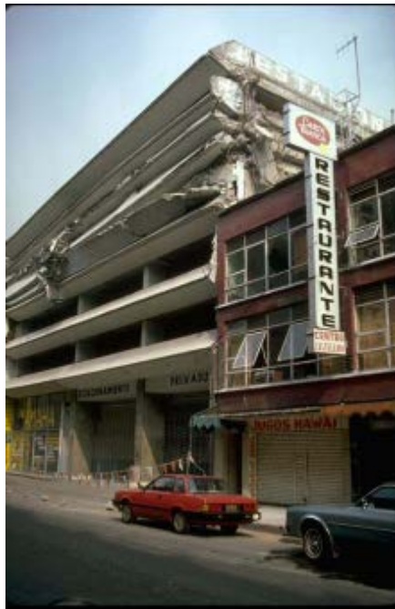
Figure II.11: « coup de fouet » dans les étages supérieurs d'un bâtiment
