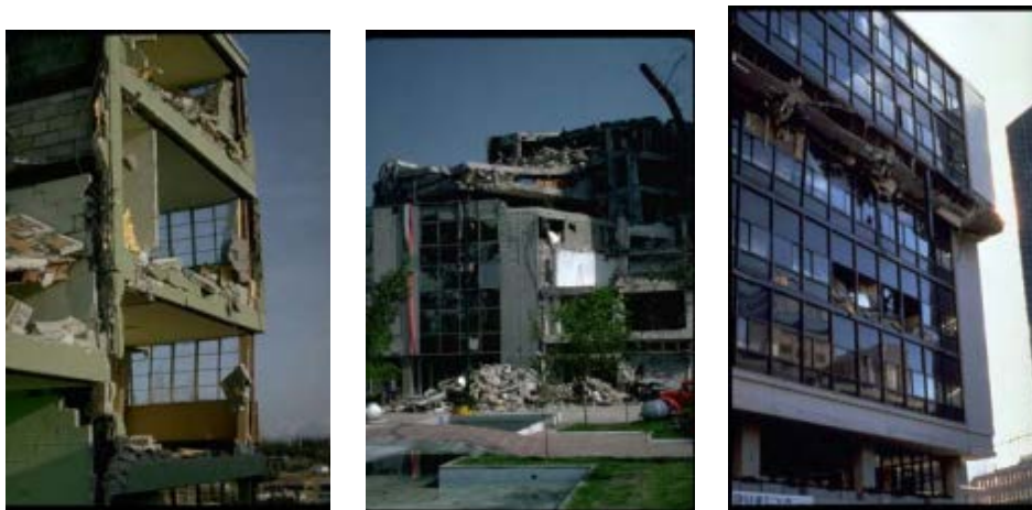
Figure II.3 : Désolidarisation des façades, destruction des étages supérieurs, intermédiaires ou inférieurs
