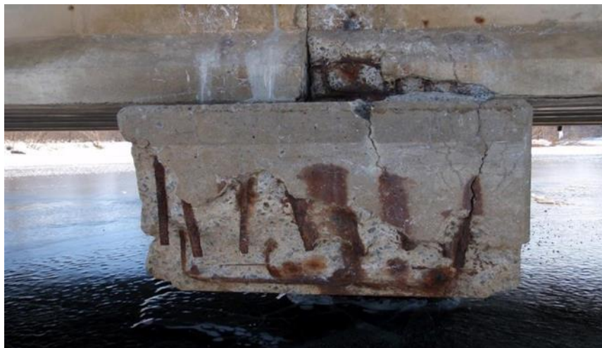
Figure I.1 : Erosion du béton [(Deghmane Y, Riou O).2018].
