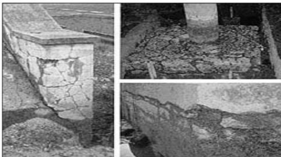
Figure 1.7: Fissuration de poutres et de poteaux d'une structure âgée atteinte d'alcali réaction [(Yahiaoui S).2006]
