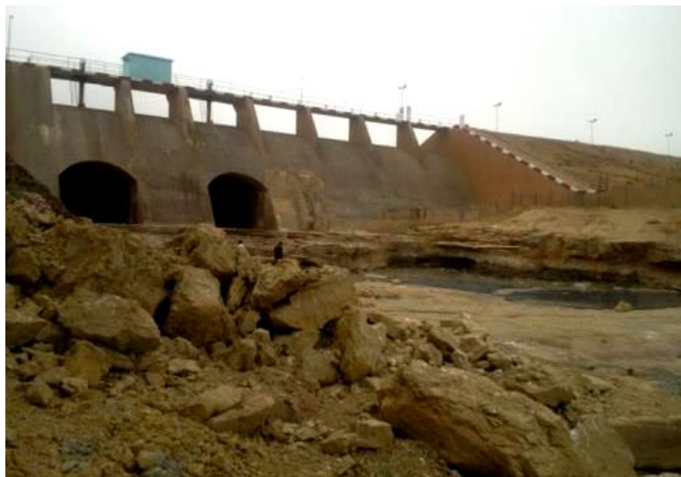
Figure V.7 : Deux vannes de fond du barrage de Boughezoul (Cliché. Remini, 2011)
