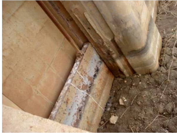
Figure IV. 9 : Blocage de la vanne de fond de la deuxième digue du barrage Boughezoul (cliché. Remini, 2011)
