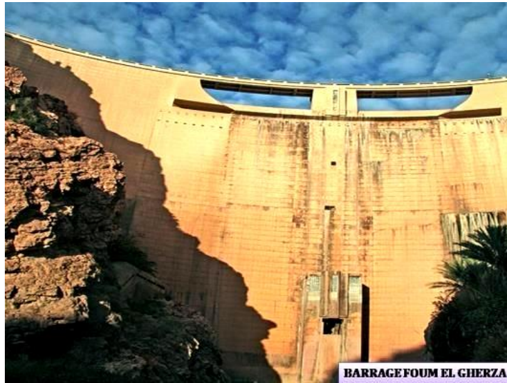
Figure V.8 : Vanne de fond du barrage de Fom El Gherza (Cliché. ANBT Biskra, 2006)
