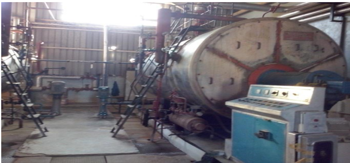
Annexe.2 le chaudière industrielle au niveaux de giplait
