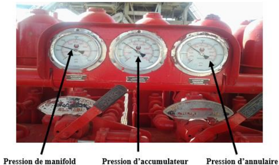
Figure II.6 : Collecteurs de contrôle hydraulique
