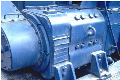
Figure I.14 : La transmission électrique
