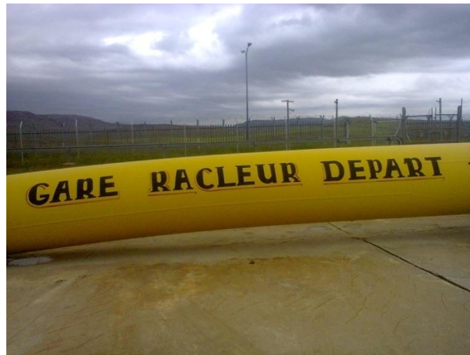
Figure 3 : Gare Racleur de la station SC4 Nador.
