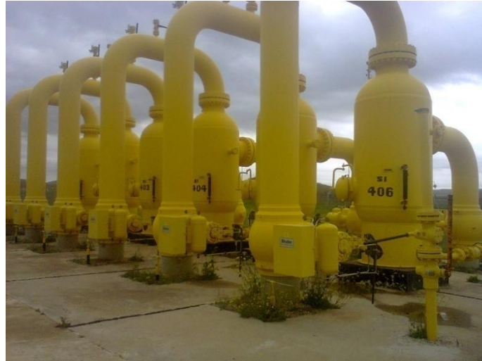
Figure 4 : Séparateurs à cyclone de la station SC4 Nador.
