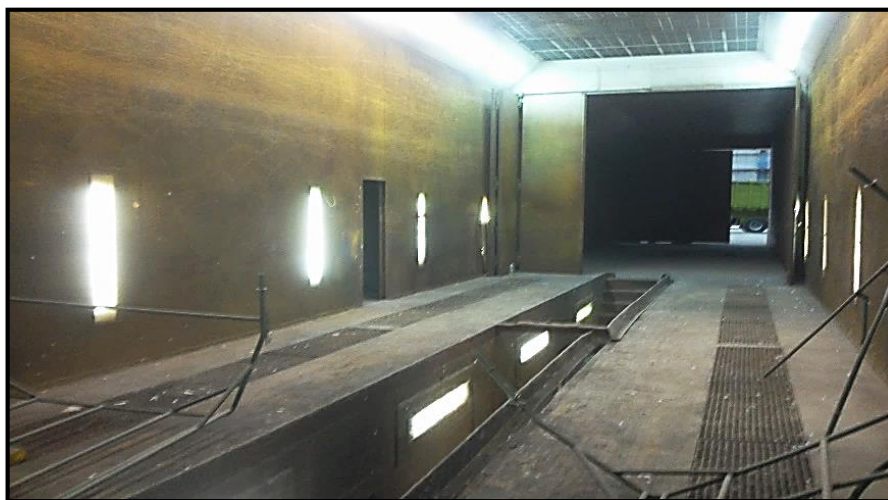
Figure II.17 : cabine de peinture
