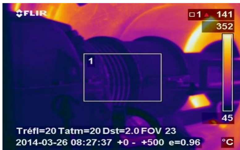
Fig IV.2: Image thermique d'un compresseur
