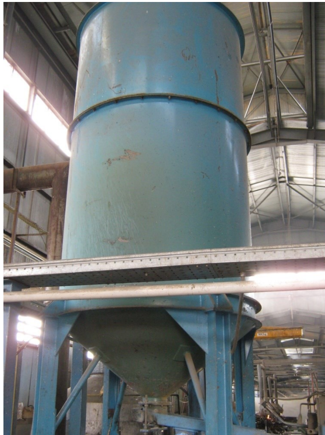
Figure (II.10) : Silo de stockage des cylindres de plomb.
